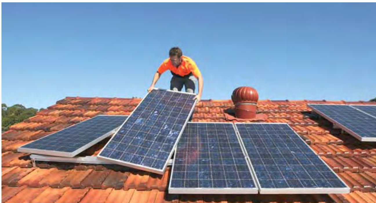
Painel solar é instalado em uma casa em Sydney: a meta é reduzir as emissões municipais de carbono em 26% até 2030
